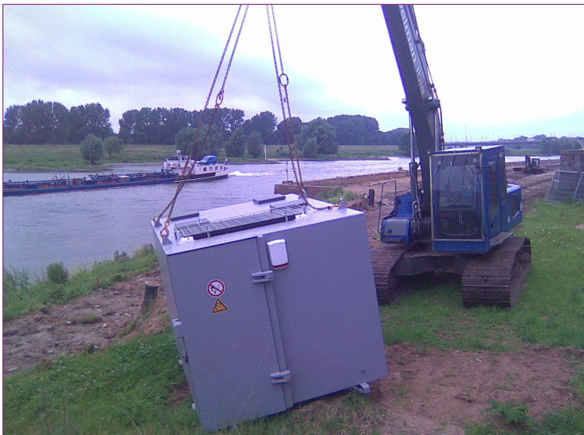
Afbeelding 37. Een speciaal uitgeruste explosieven-opslagcontainer (rechts).
