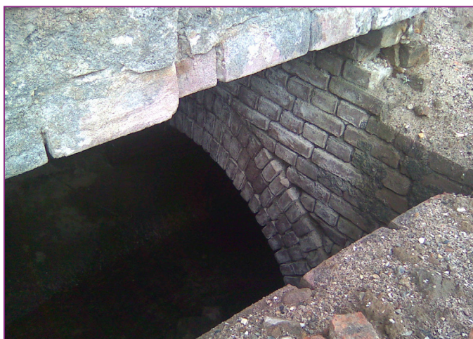
Afbeelding 33. Detail van opening in rioolbuis.
